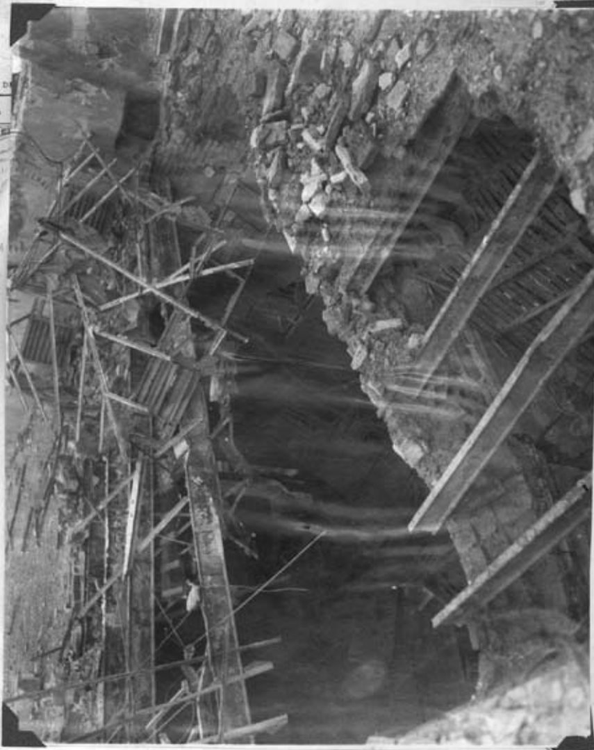
ASPECTO DE LOS DAÑOS OCACIONADOS EN LA TERRAZA DE LA CASA DE GOBIERNO.-
