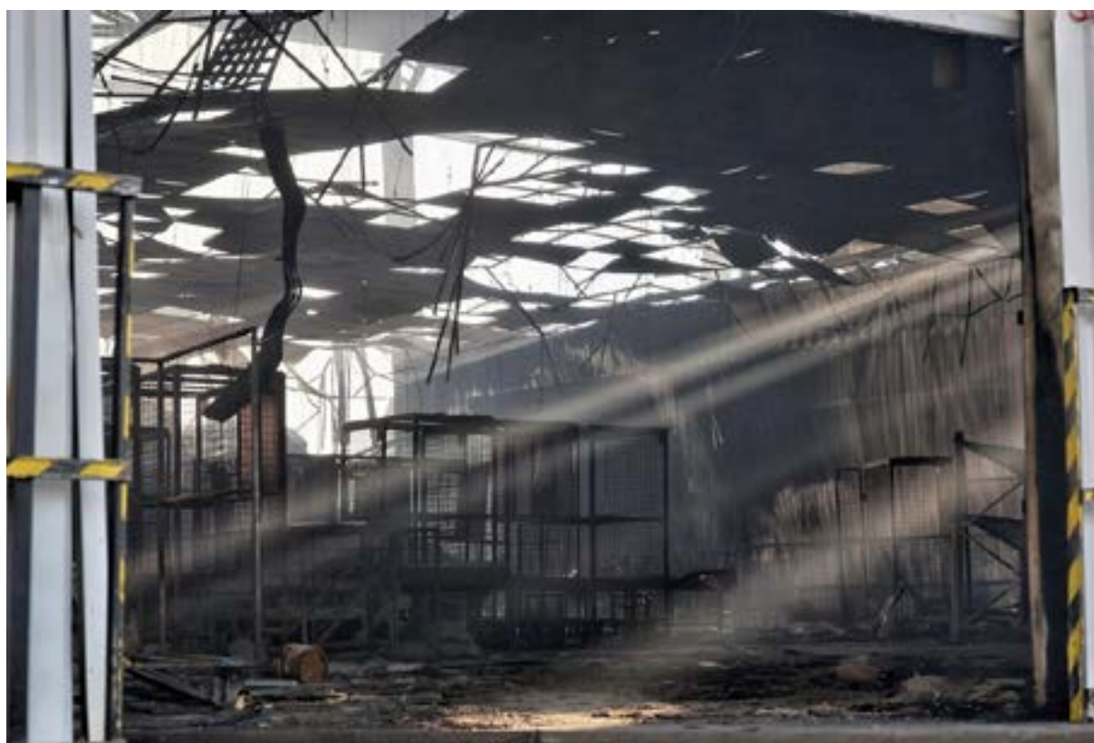
Almacén dañado por los ataques en Odesa, Ucrania (Fuente: https://photonew.ukrinform.com/DPA )
